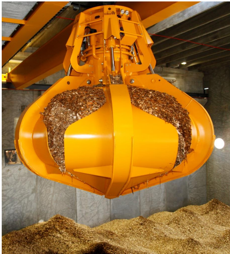
Kranen på biomasseanlægget
