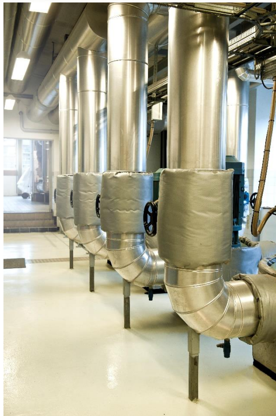
Fra pumperummet på Buen-centralen
