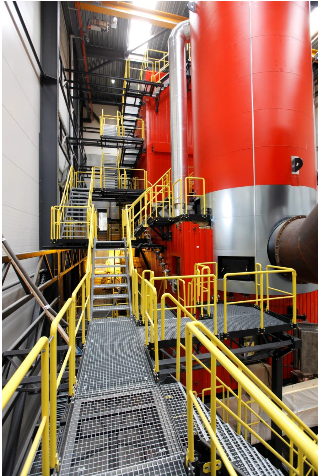
Det nye biomasseanlæg
