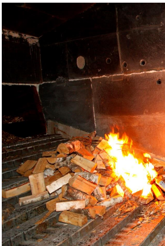
Første optænding i den nye biomassekedel – ved den lejlighed var træflis erstattet med pejsebrænde.
