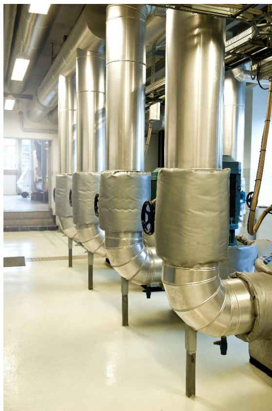
Fra pumperummet på Buen-centralen
