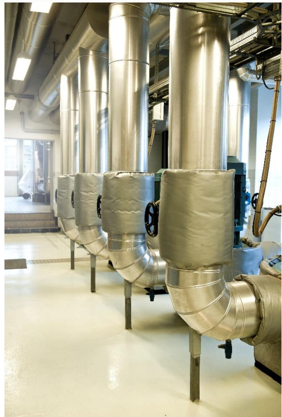
Fra pumperummet på Buen-centralen
