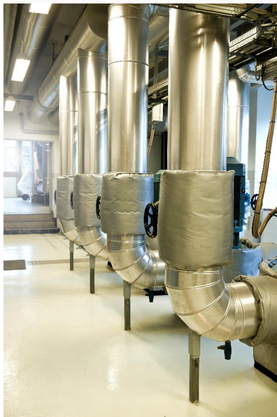
Fra pumperummet på Buen-centralen
