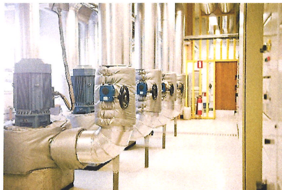
Fra pumperummet på Buen-centralen
