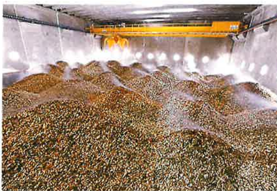
Indendørs flislager Biomasseanlægget
