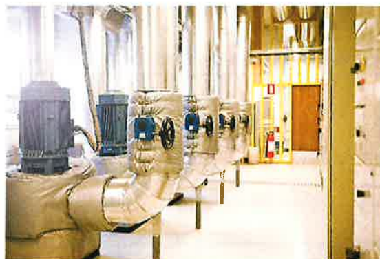
Fra pumperummet på Buen-centralen
